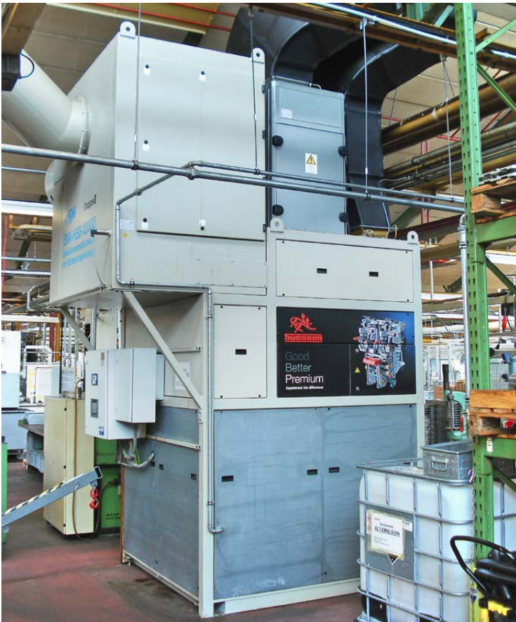
Systeme zur Wärmerückgewinnung verringern den Gasverbrauch.
